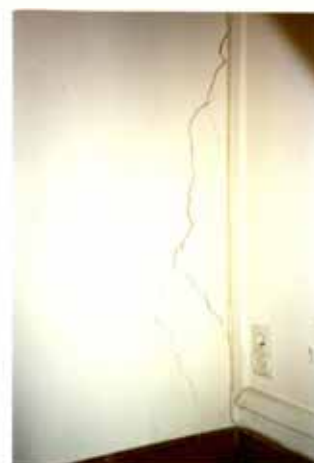
NARGIS, période de sécheresse 1989-1997 : fissure à l'intérieur d'une habitation -
