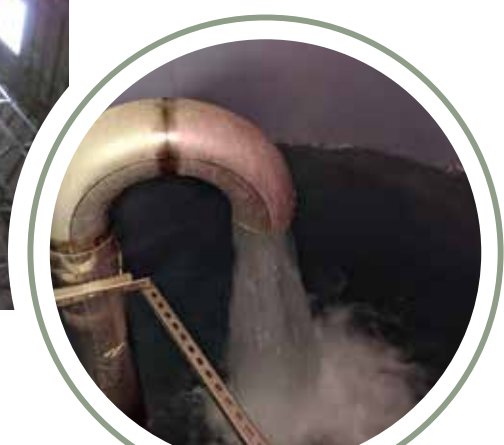
Arrivée d'eau dans le réservoir
