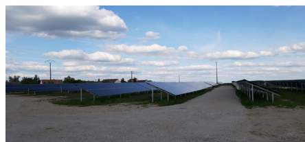
Centrale photovoltaïque, Préfontaines
